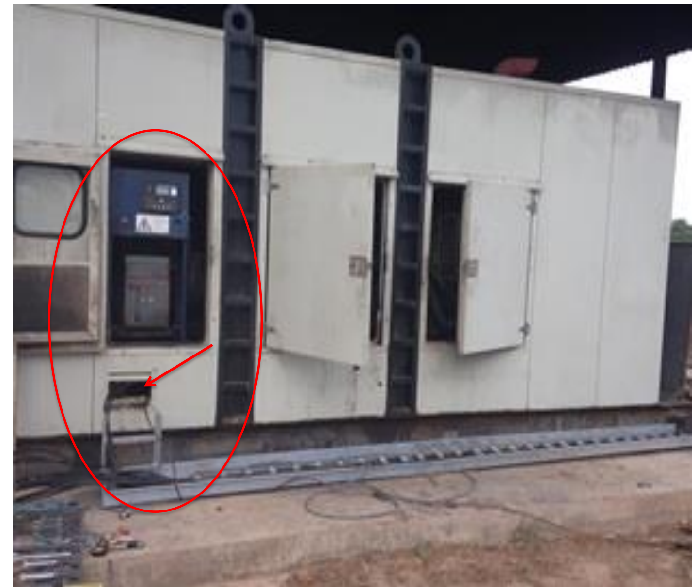
• Foto 2. Se evidencia los dos cables que estaban conectado en el generador 5 y el cable polo a tierra
