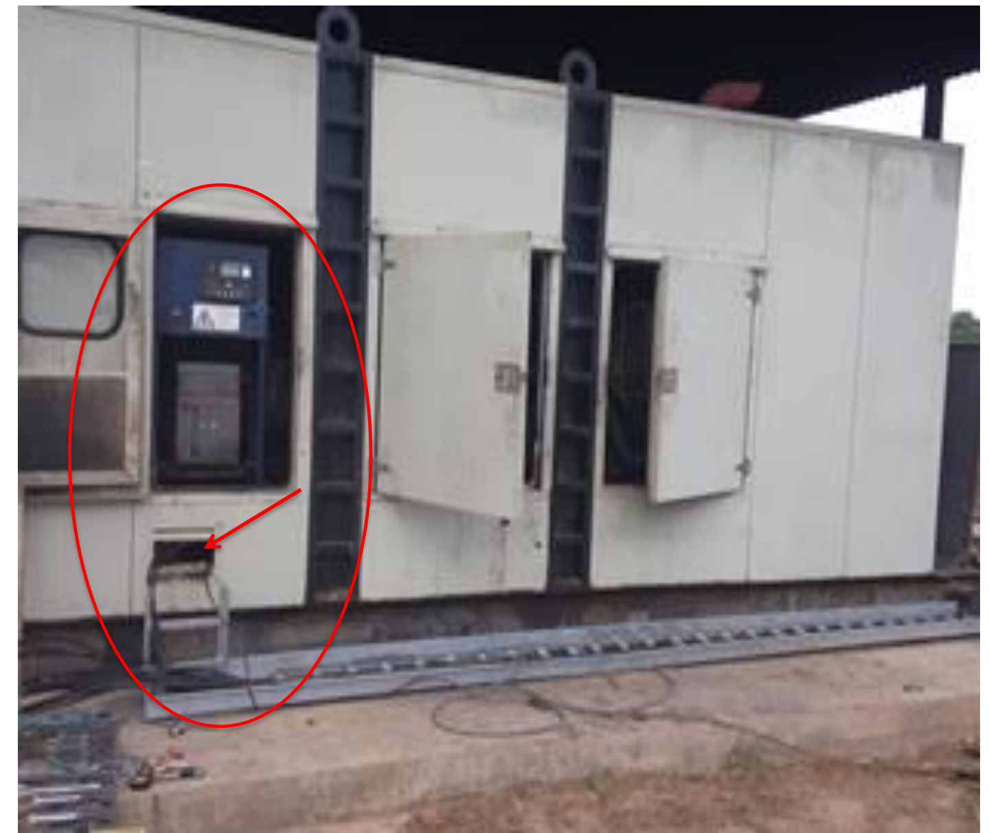
• Foto 2. Se evidencia los dos cables que estaban conectado en el generador 5 y el cable polo a tierra
