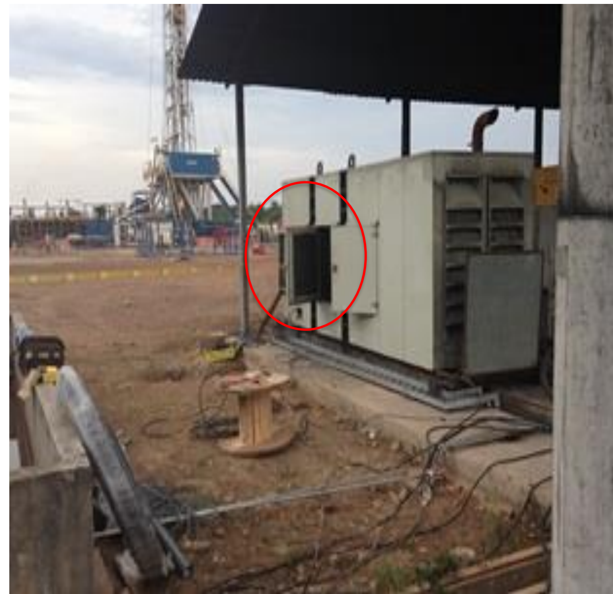
• Foto1. Generador del accidente, en el círculo de color rojo se señala la puerta por donde ingresa el trabajador a realizar la conexión del cableado al barraje del generador 5.
