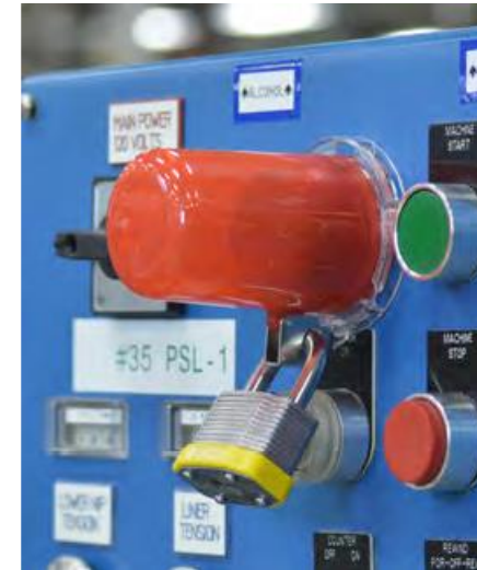
Bloqueadores de Botón – Tablero de control
