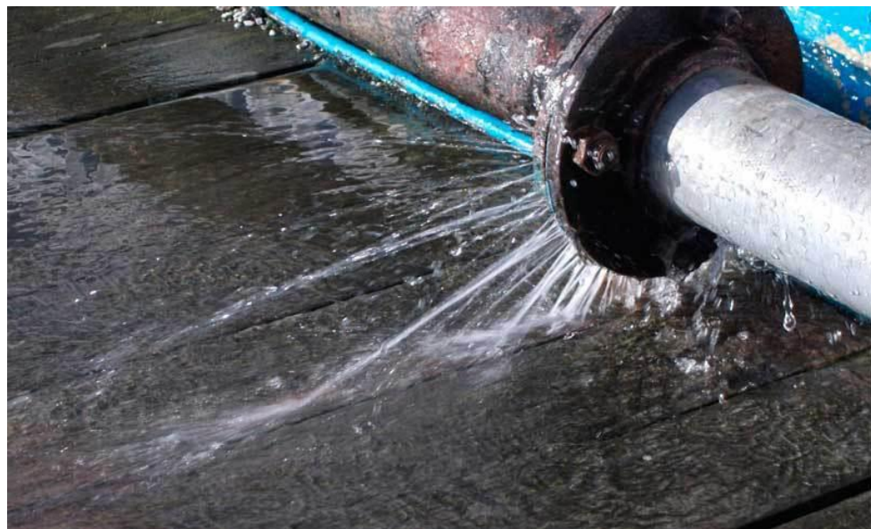
Fugas de agente químico en estado líquido
