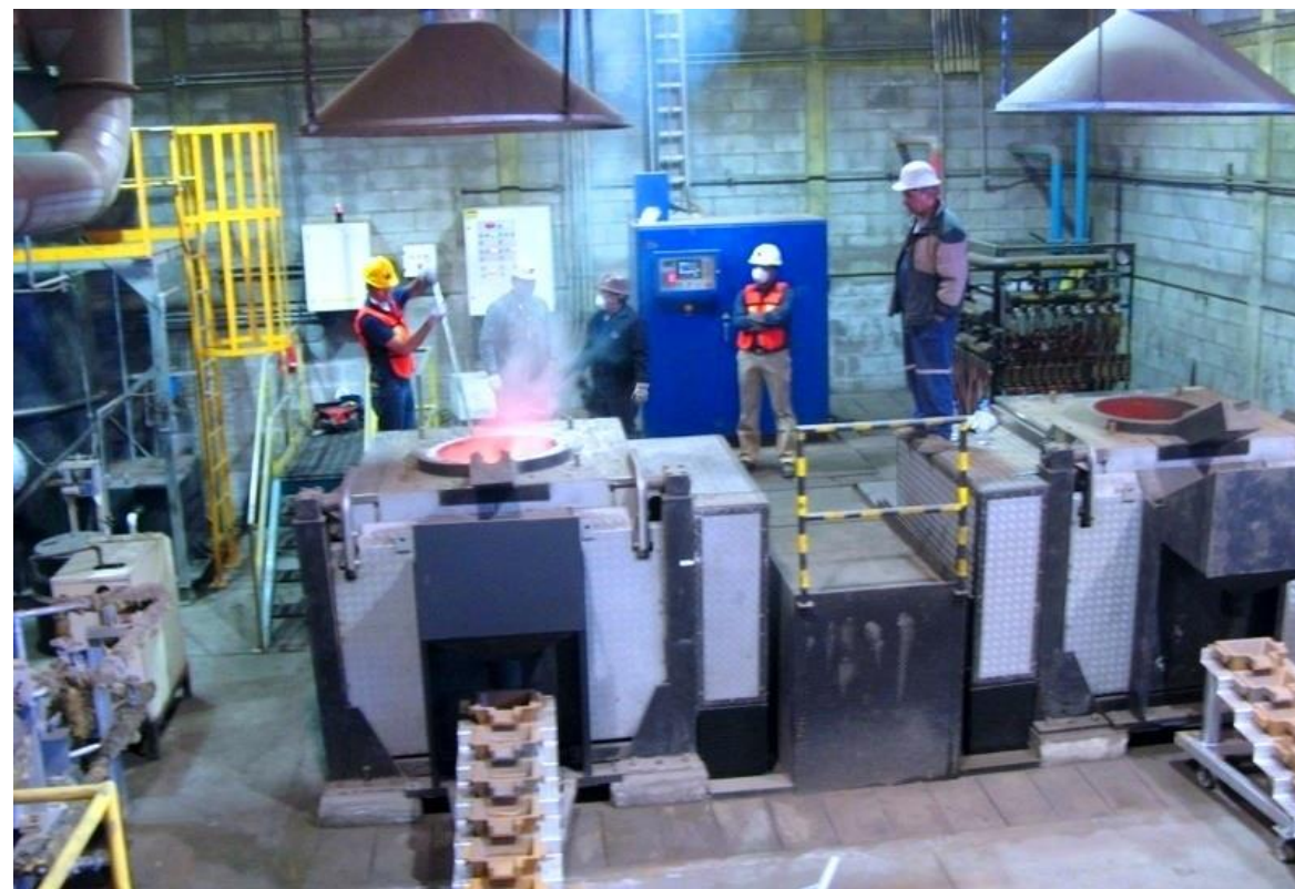
Hornos y calderas.
