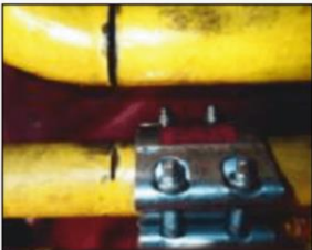
La abrazadera que se muestra en la imagen se instaló después del incidente para parar la fuga
