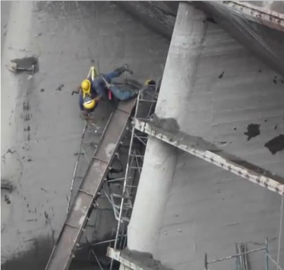
EMERGENCIA – ALTURAS - CALIENTE
