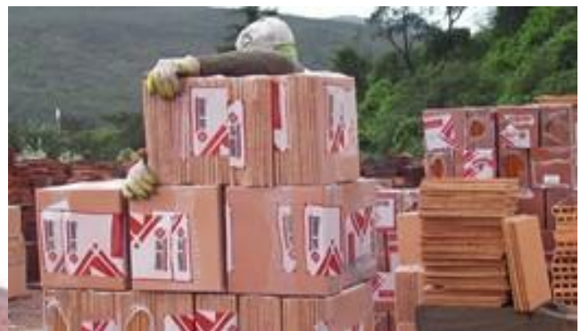
Gráfica 30. Con el fin de facilitar la manipulación, el desplazamiento y el transporte de las cargas, se recomienda estabilizar las zonas de estibado con soportes o estructuras metálicas.
