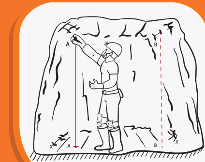
Utilice sostenimiento provisional
